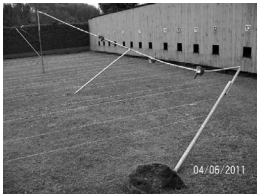
Die Nachtbeleuchtung wurde stark beschädigt.
