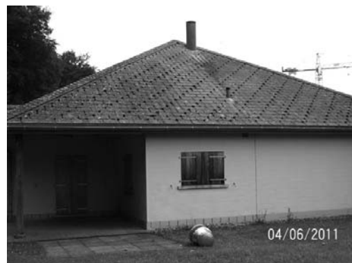
Der Kaminhut und etliche Ziegel wurden vom Dach geworfen.
