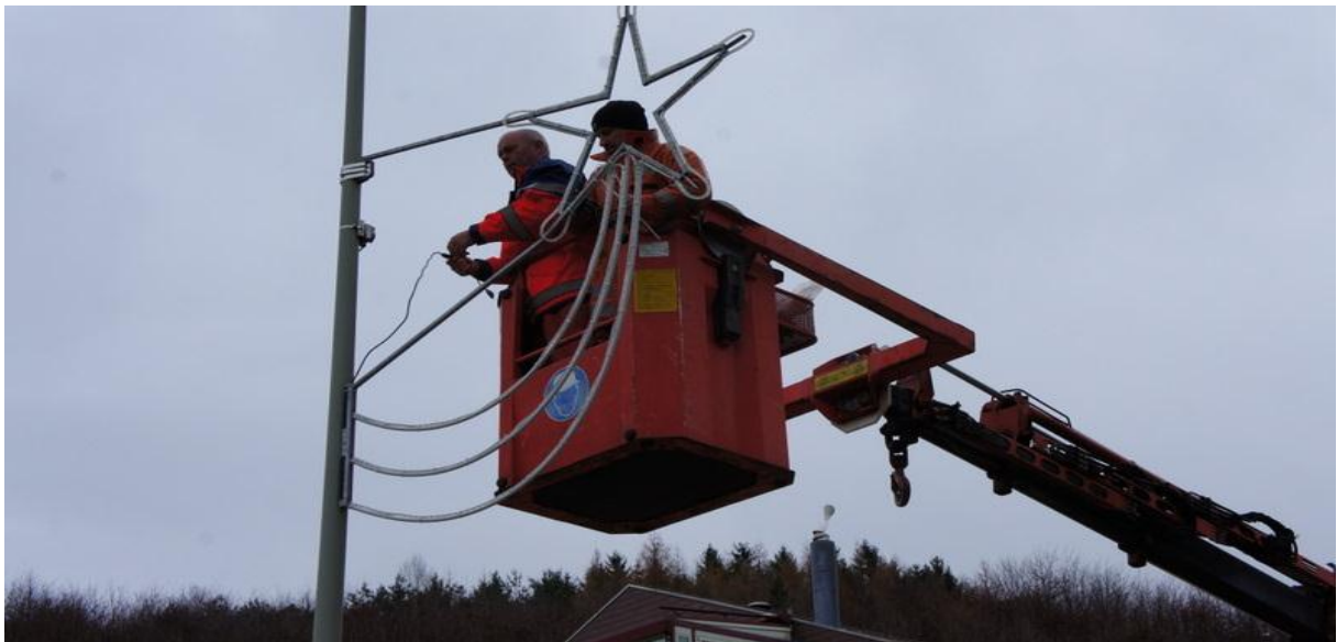
Foto X Nachdem in der Energiestadt Lindau bereits mehrere Strassen mit LED-Leuchten ausgerüstet wurden, ist die konsequente Umrüstung der Weihnachtsbeleuchtung ein weiterer logischer Schritt auf dem Weg zum sparsamen Umgang mit Energie.
